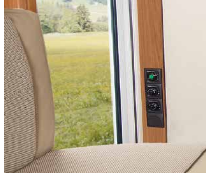
+ Yleisvalon katkaisijat ulko-oven vieressä sekä makuutilassa
