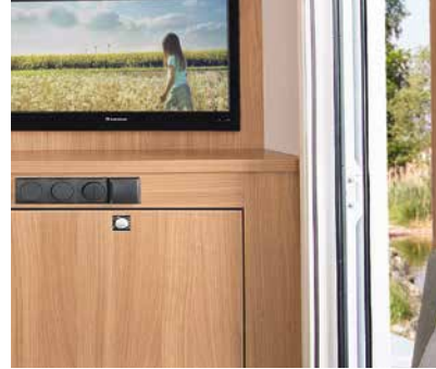
+ Yleisvalon katkaisijat ulko-oven vieressä sekä makuutilassa
